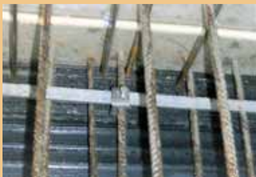
Fundamenterder mit Bewehrungsklemme.
