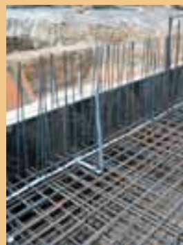
Fundamenterder mit Abzweig und Verbindungs- und Bewehrungsklemme.
